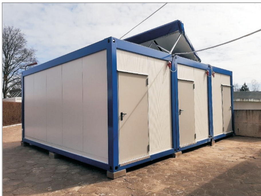
Fot. 1. Widok finalnego ustawienia zestawu 3 kontenerów z widocznymi kolektorami solarnymi na dachu kontenera technicznego – ZRJ IRS Olsztyn (fot. D. Ulikowski).
