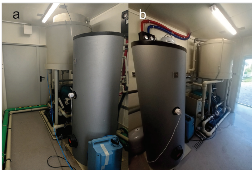
Fot. 3. Widok wnętrza kontenera technicznego: (a) widok od strony zbiornika grzewczego, (b) widok na urządzenia techniczne RAS (fot. D. Ulikowski).
