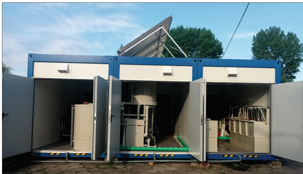
Fot. 2. Widok finalnego ustawienia zestawu 3 kontenerów I (fot. D. Ulikowski).
